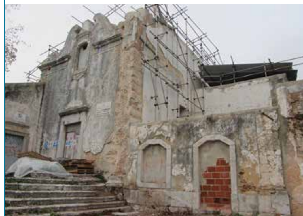
Figura 1. Aspecto geral do convento de S. Paulo e pormenor da igreja com as estruturas de reforço emergencial colocadas após o incêndio.
