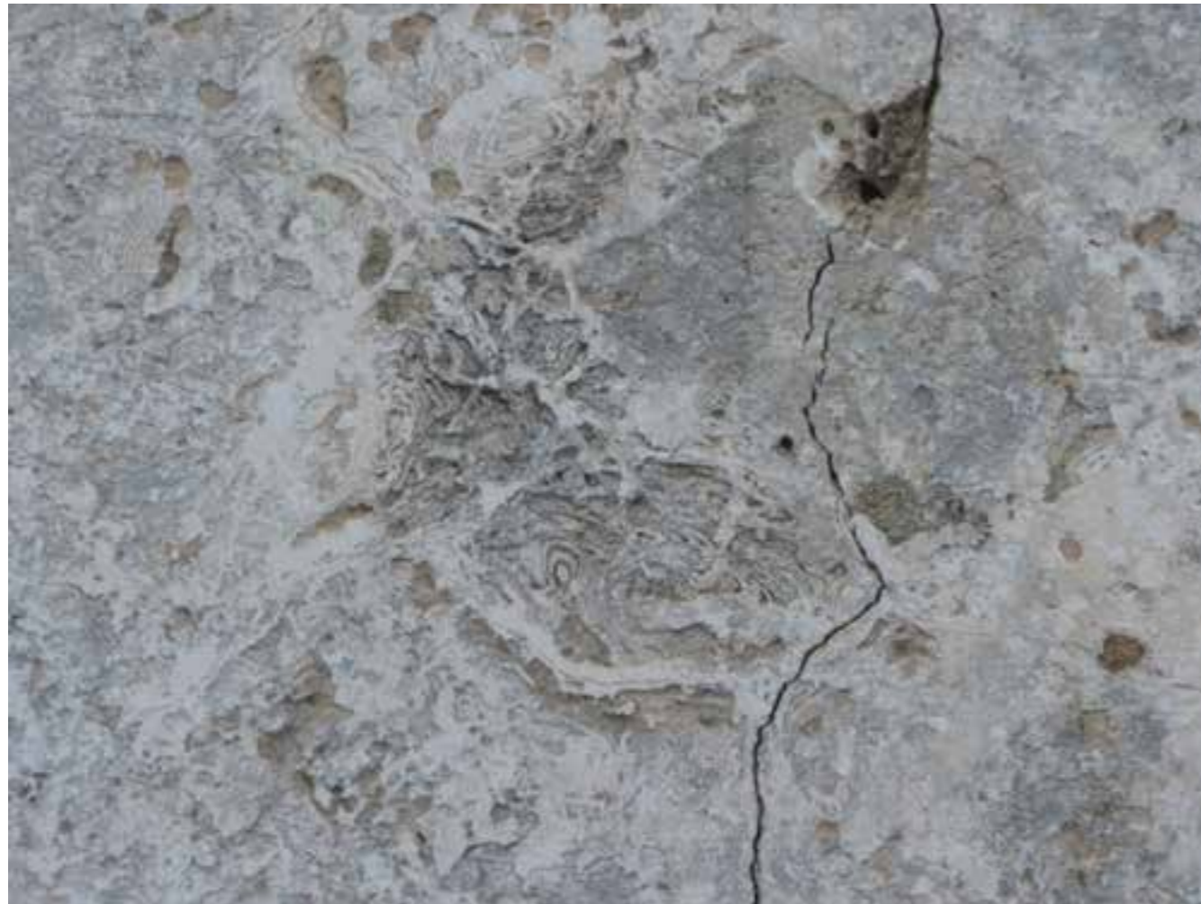
Figura 6. Aspecto de uma fractura de grande desenvolvimento e de lacunas dispersas do reboco.
