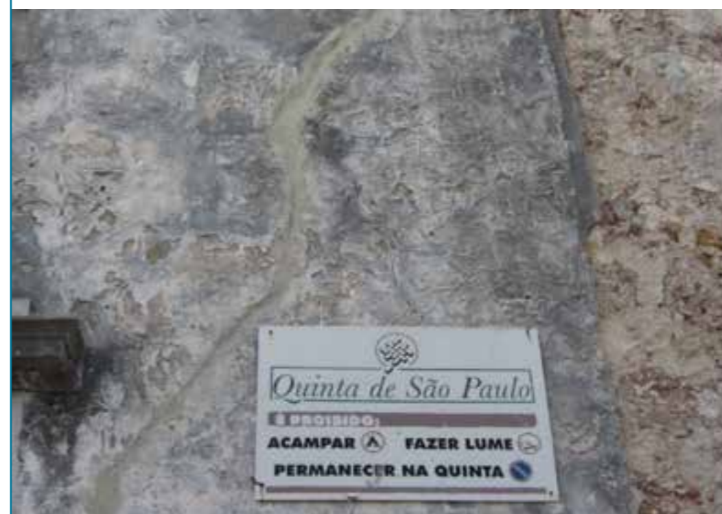
Figura 2. Aspecto dos rebocos dos paramentos exteriores do claustro e da fachada da igreja que foram definidos para serem conservados.
