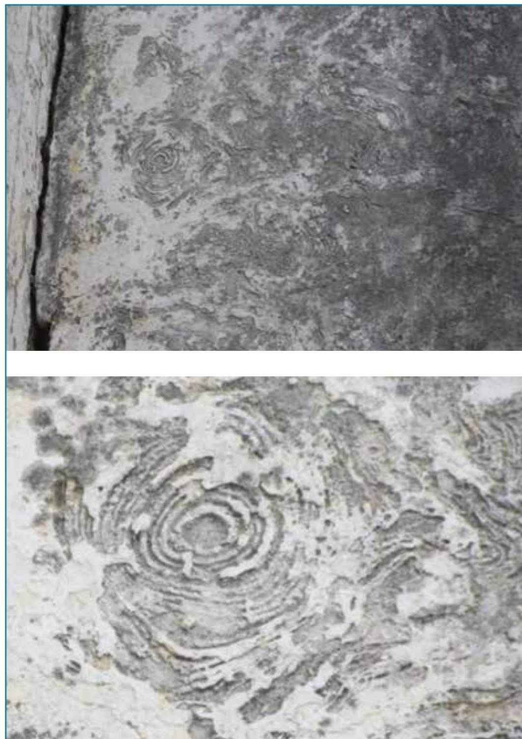
Figura 3. Aspecto de um trecho de parede com o padrão de erosão diferencial e pormenor de uma dessas áreas onde se identificam os anéis concêntricos de maiores e de menores resistências à deterioração.
